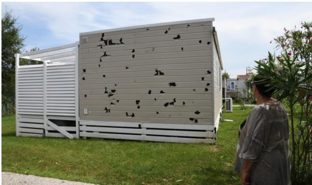
Le strutture danneggiate di un campeggio.
